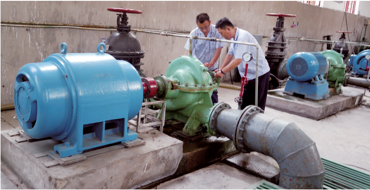
董庄水厂工作人员在巡检机泵设备。付家宝 摄
