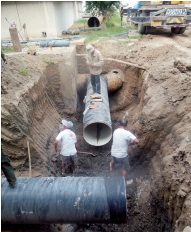
南水北调工程管道进入水厂。资料图片
