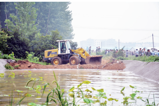
图为对路边的一处“鱼塘”进行拆除,该“鱼塘”周边并未设置防护网和警示标志。
